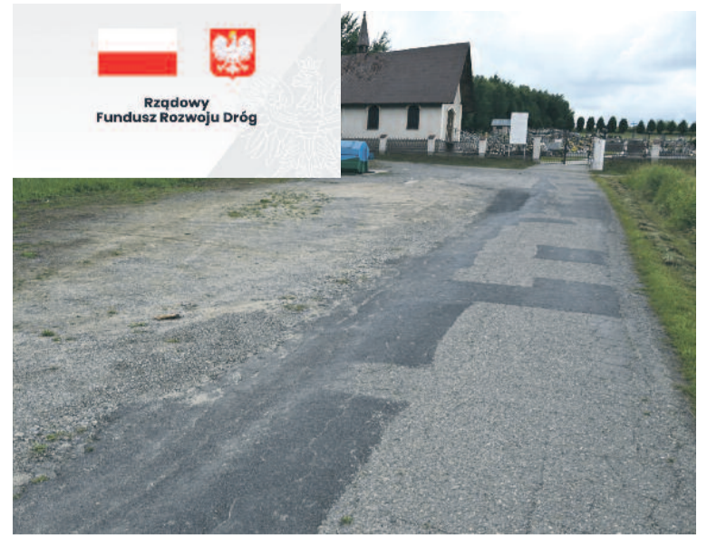
Ulica „cmentarna” potrzebuje pilnie remontu.
